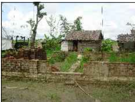
ナルギスによって破壊された病院
