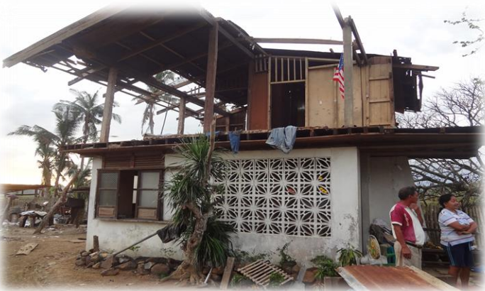
【台風の被害の様子】
